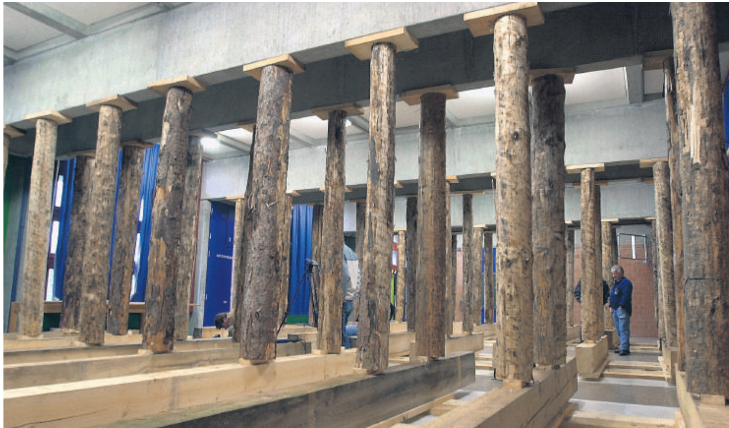
Kaserne Bremgarten AG (2002): Wegen Einsturzgefahr musste die Decke mit Holzpfählen gestützt werden
