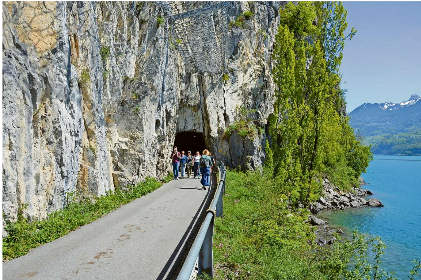
Zwischen Fels und Walensee: Die Tunnels in der Betliserstrasse müssen saniert werden.
