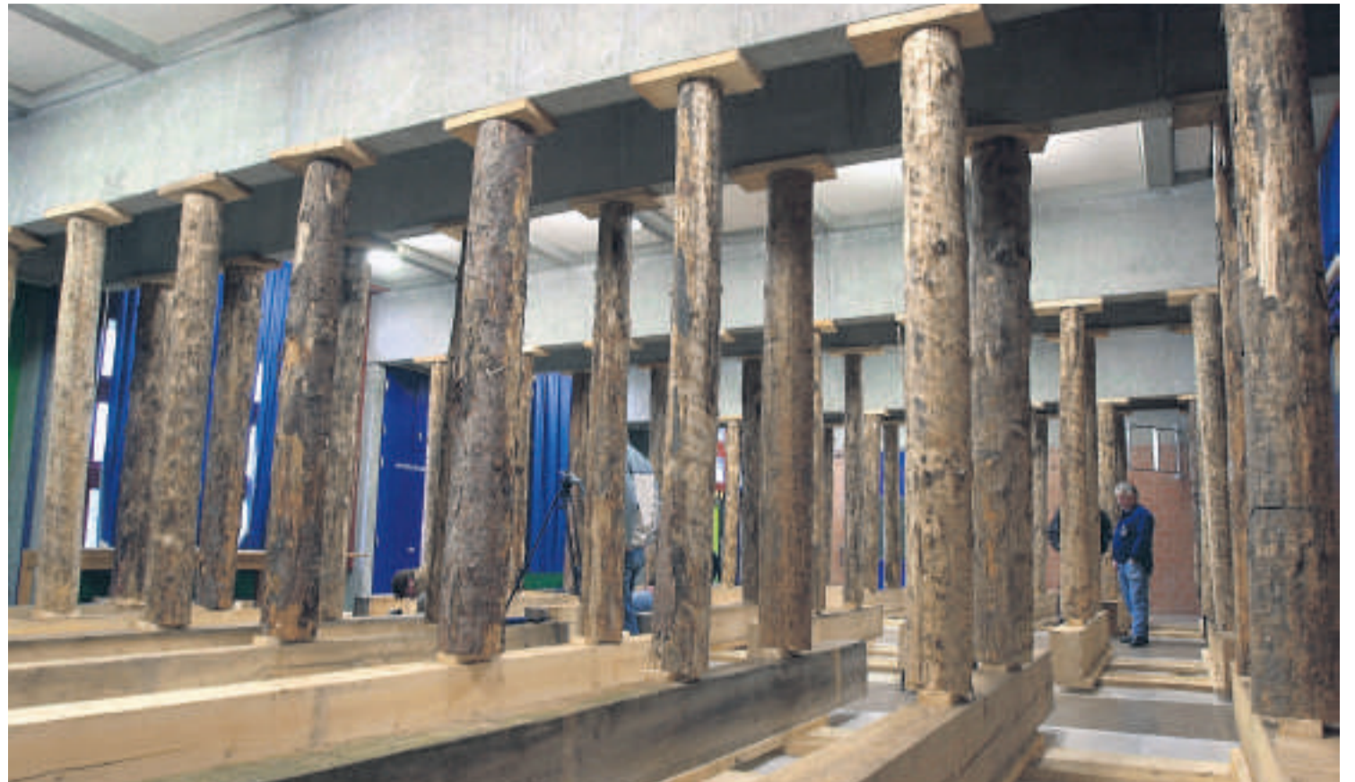
Kaserne Bremgarten AG (2002): Wegen Einsturzgefahr musste die Decke mit Holzpfehlern gestützt werden
